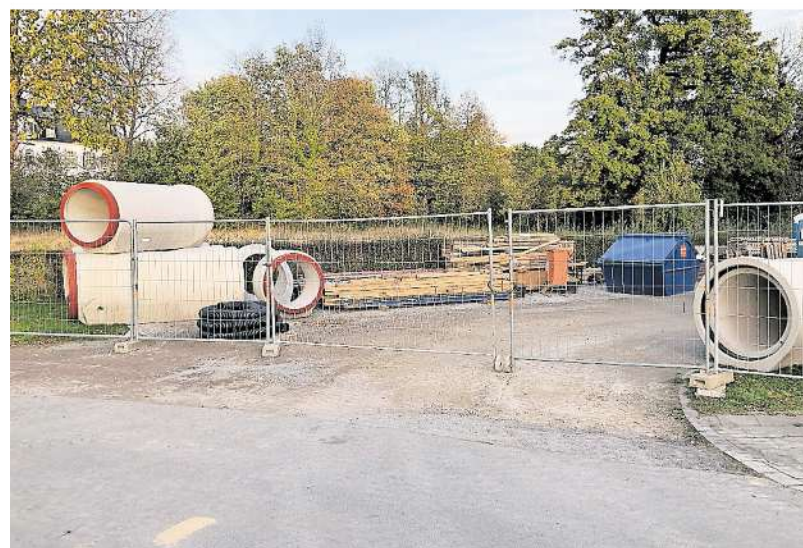
Der Parkplatz am Schloss Zweibrüggen steht nicht mehr zur Verfügung.
